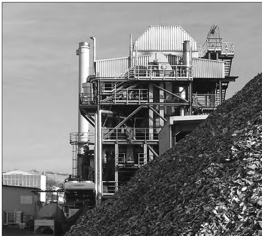
Nový typ biomasové teplárny, který byl poprvé na světě uveden do provozu v Güssingu. Za hodinu vyrobí z 1 760 kg dřeva 2 000 kWh elektřiny a 4 500 kWh tepla. Zdroj de.wikipedia.org
