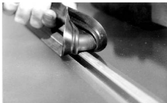
Obr. 53: Pokládání krycí gumy
