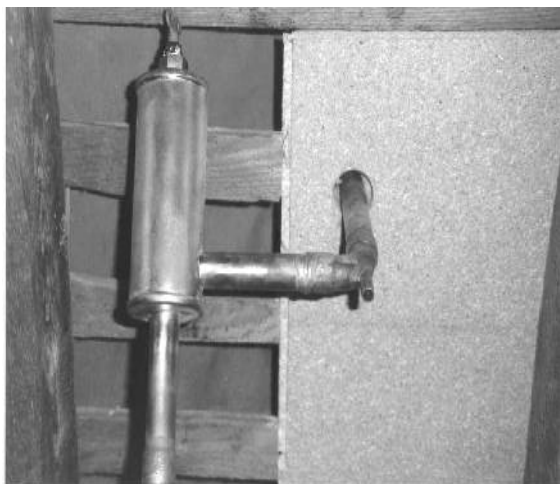
Obr. 58 Odvzdušňovací nádobka s ručně ovládaným ventilem a zvláštní upevnění trubičky pro čidlo, která v přívodním porubí zasahuje až do kolektoru
