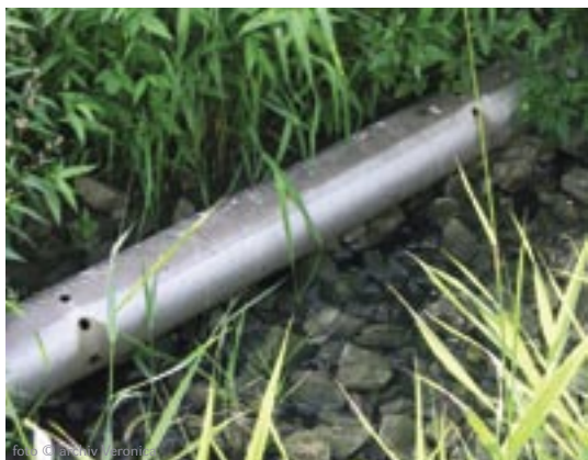
Detail rozdělovacího potrubí na povrchu filtračního lože.
