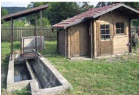
Pohled na lapák písku a provozní přístřešek v mechanickém stupni čištění.
